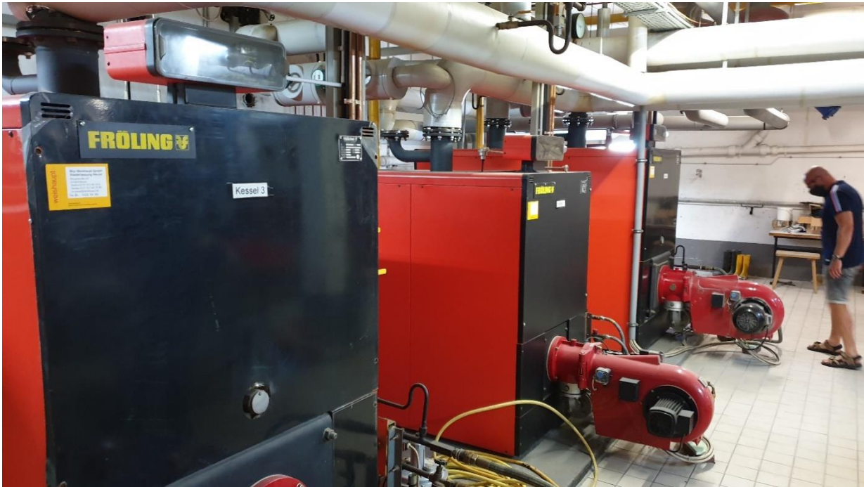
Abb. 01 Heizkessel mit Zweistoffbrenner (Öl und Gas)
